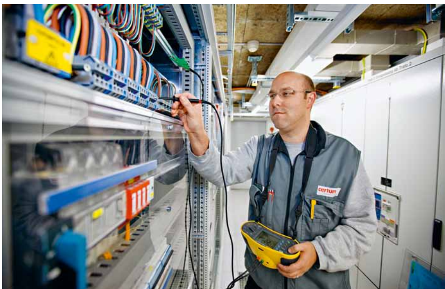
Certum-Sicherheitsberater Martin Truffer, Leiter Region Aargau, kontrolliert im Technikraum einer Tiefgarage, ob die elektrischen Anlagen richtig installiert sind.
