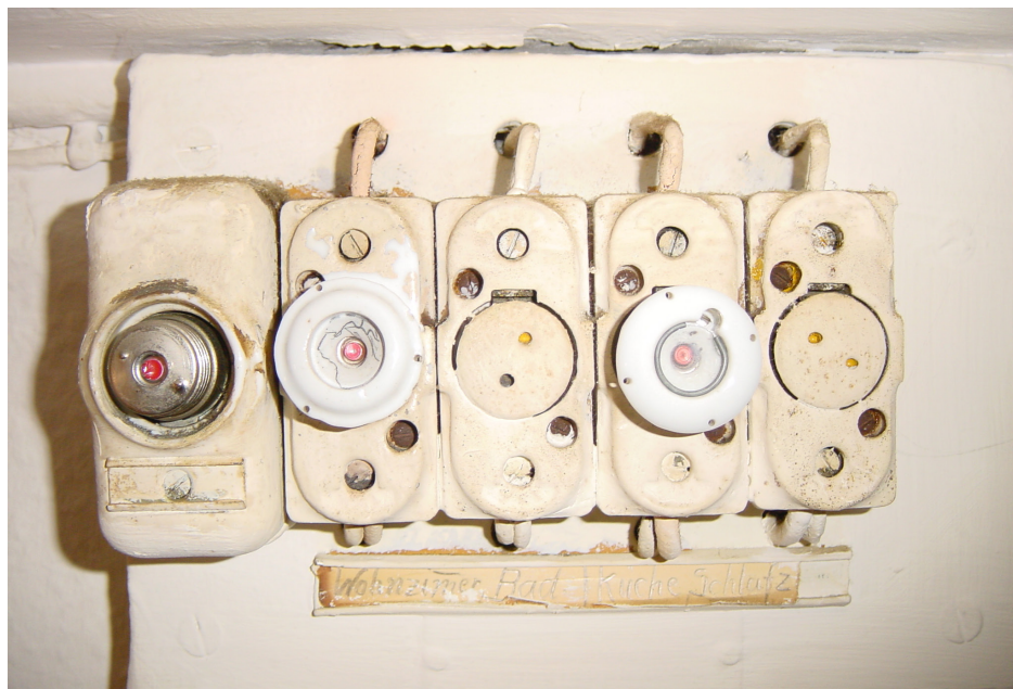
Unterschätzte Gefahr: alte Elektroanlage.
