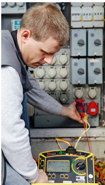
Philipp Schreiber kontrolliert die Fehlerstromschutzeinrichtung.
