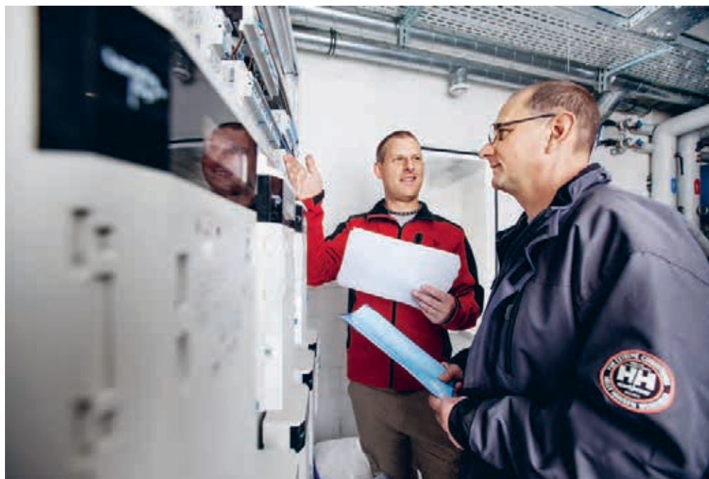
Philipp Schreiber (links) bespricht mit dem Elektroinstallateur die geplante Erweiterung der SK.
