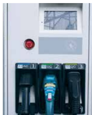
Schnellladestation mit Gleichstrom- und Wechselstromladung \leq 200 A.
