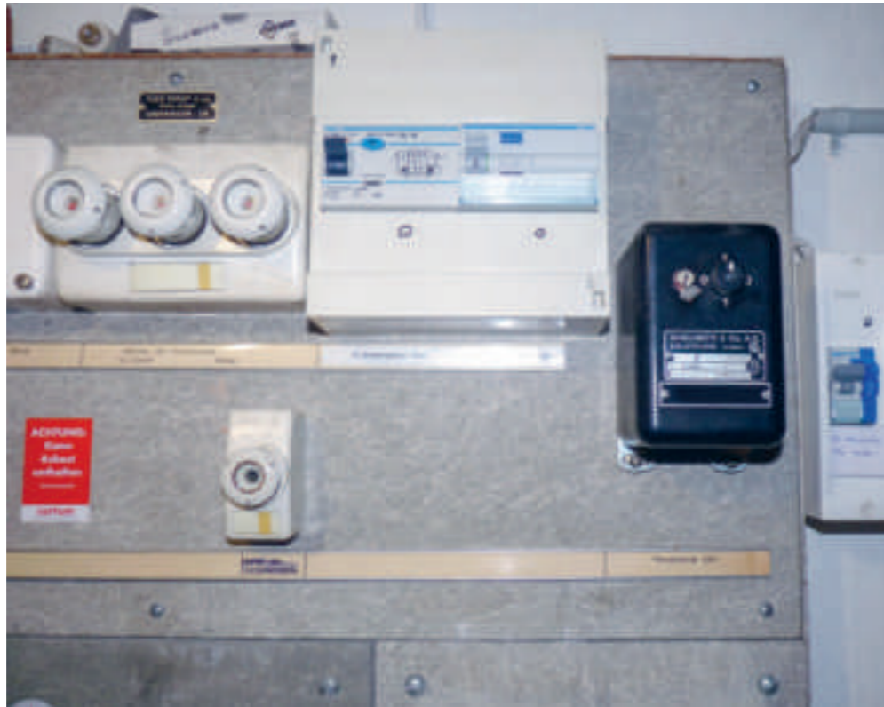
Gefährlicher Kompromiss: Installationserweiterung auf asbesthaltiger Verteilung
