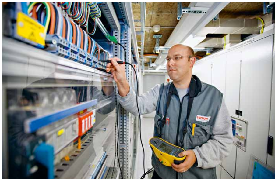
Certum-Sicherheitsberater Martin Truffer, Leiter Region Aargau, kontrolliert im Technikraum einer Tiefgarage, ob die elektrischen Anlagen richtig installiert sind.
