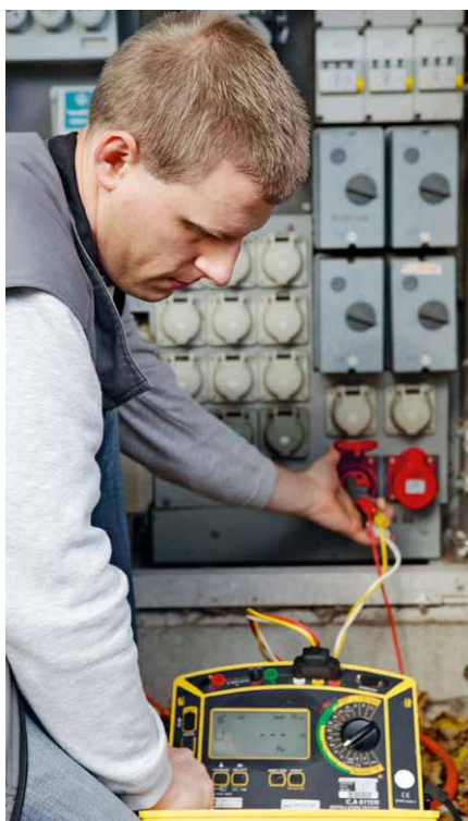
Philipp Schreiber kontrolliert die Fehlerstromschutzeinrichtung.
