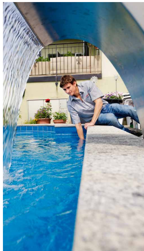
Die Druckluftschalter im Pool funktionieren einwandfrei.
